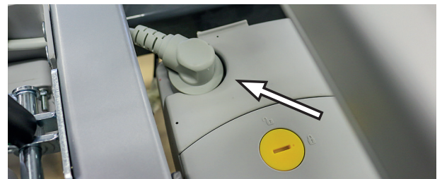
Anschluss des Netzkabels an der Steuereinheit.
